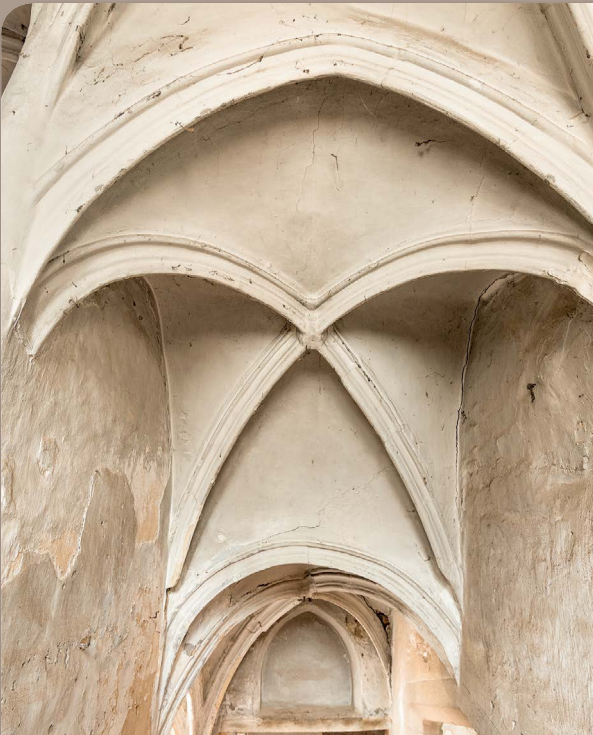
Mechelen. Hof van Palermo (15 e eeuw). Voormalige residentie van Jan II Carondelet, raadsheer van de Grote Raad van Mechelen. Project in uitvoering 2016.
